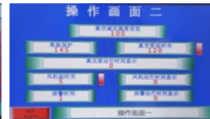
电箱界面 2 PLC 2
