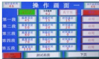
电箱界面 1 PLC 1
